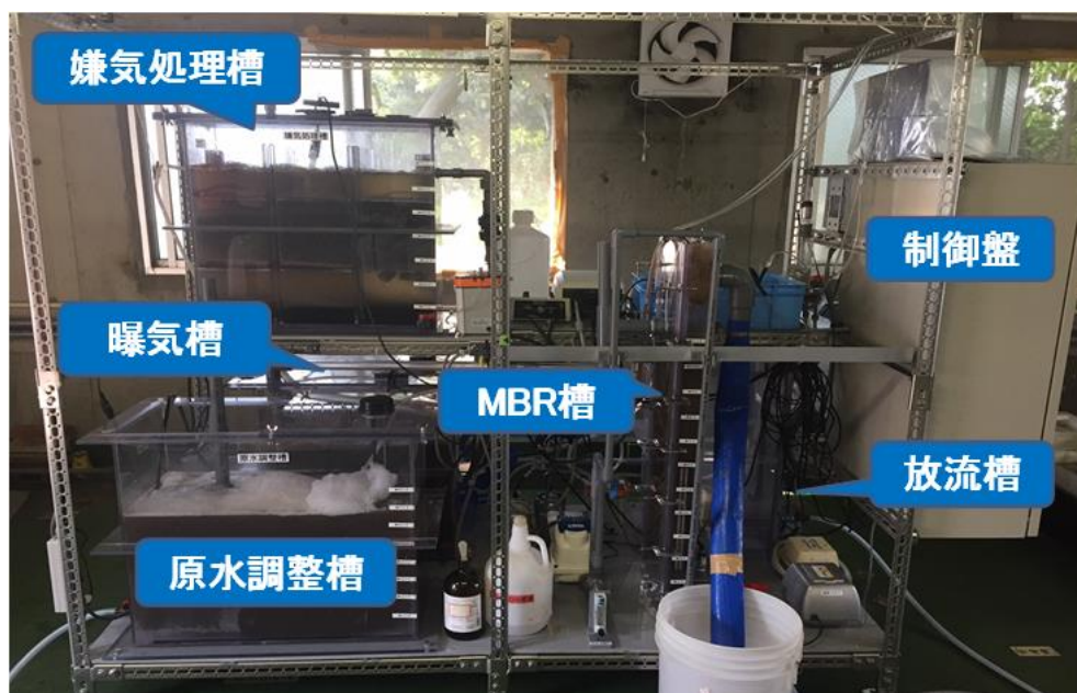
図6 実験装置を用いた総合排水の処理状況
